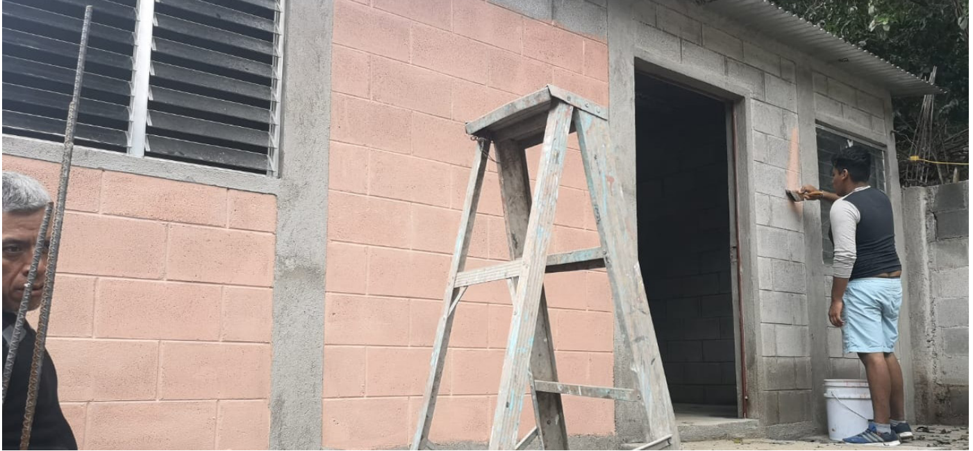
Programa PROVIDI para la de dotación de materiales de construcción para las comunidades. Guatemala, 2018. CIV
