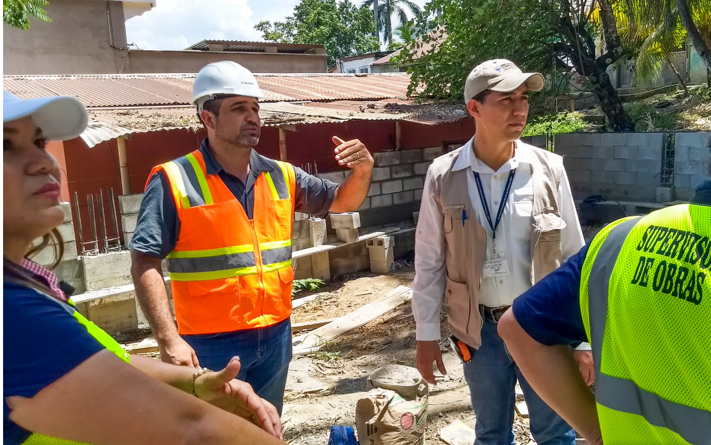
Construcción sistema de agua potable con perforación de pozo para abastecer al Barrio El Rastro y El Estrecho, Casco Urbano, Puerto Barrios, Izabal. 2018. SCEP
