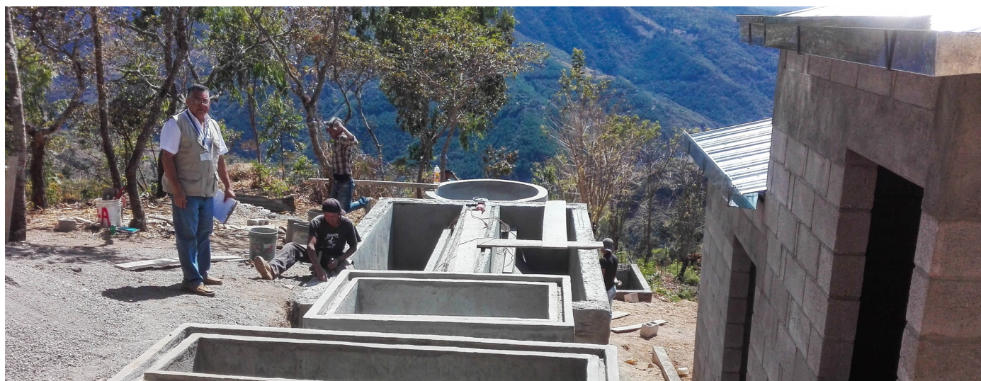
Construcción sistema de alcantarillado sanitario sector Gregorio Ajcuc - Salvador Román, Cantón Central, Chuarrancho. 2018. SCEP
